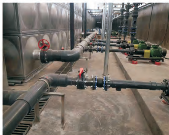
▲ 南亚化工管工程
