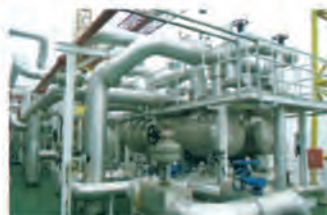
▲ 工业冷热水输送管道
