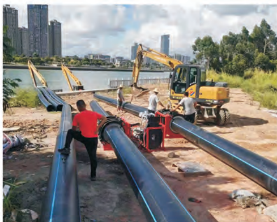
▲ 厦门银鹭食品饮料工程
